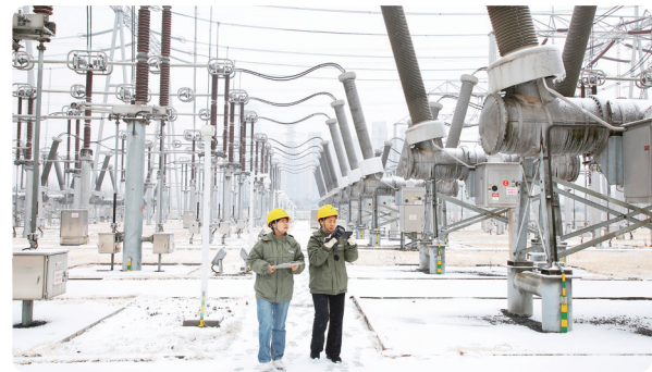
大雪天气运维人员开展特巡
