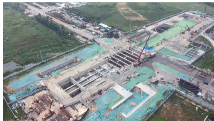
7月31日,合肥轨道交通2号线东延线工程11座车站全部实现结构封顶
