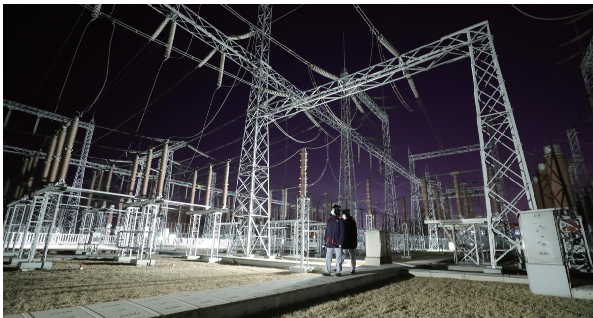
在国家电网沈阳供电公司浑河变电站,工作人员对电力设施进行巡视。(资料图 新华社记者 杨青/摄)
