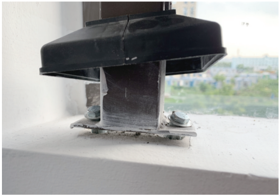
阳台护栏螺丝未完成安装
