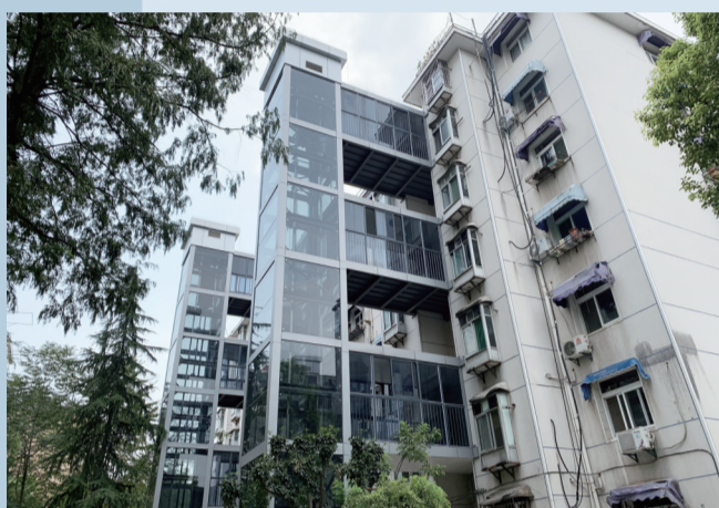
省公安厅宿舍内住宅楼加装的电梯
