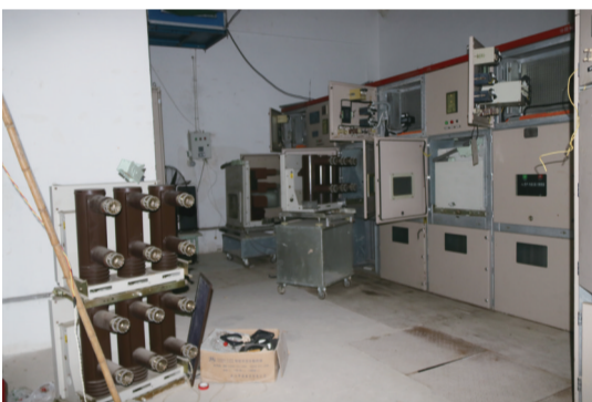
出故障的配电房
