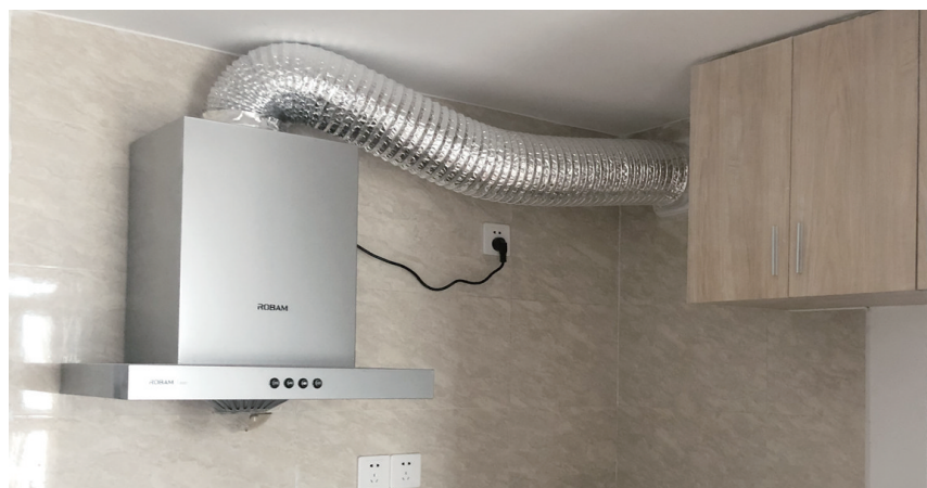
油烟机管道外露
