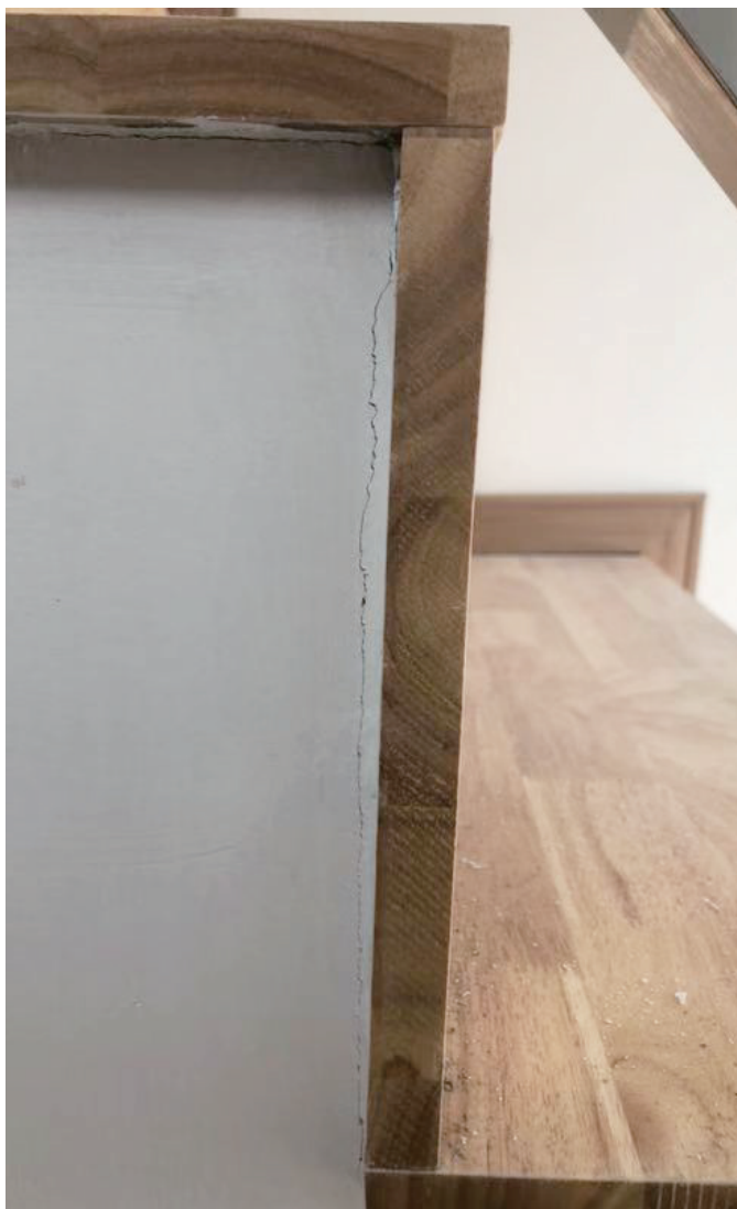
墙体多处裂缝
