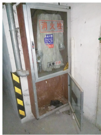
蓝岸雅居地下车库灭火器箱里面是空的
