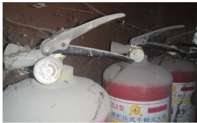
彩虹家园地下车库的灭火器指向红色区域，已经失效
