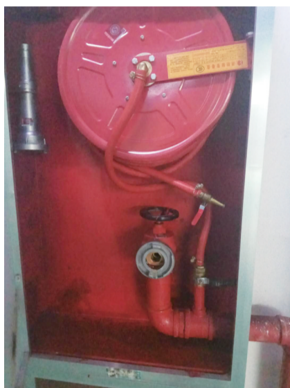
平安家园地下车库一消防栓并没有消防水带
