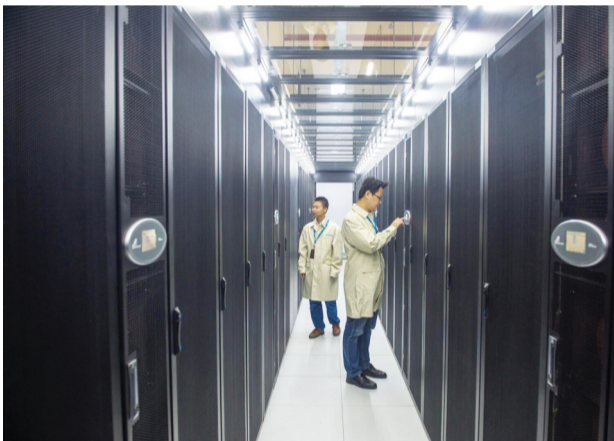
在中国移动(安徽)数据中心，技术人员正在巡检存储机柜
