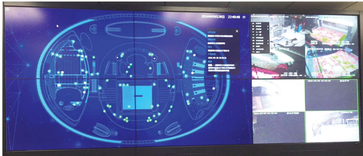
科大立安智能消防系统
