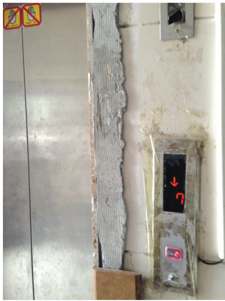
玫瑰绅城B区的电梯破残的厉害
