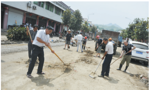
诸佛庵镇上 干群在打扫街面的淤泥
