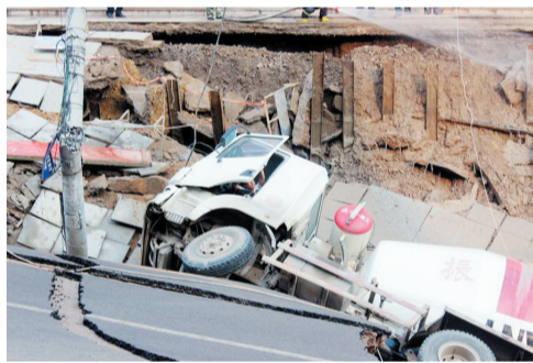
大罐车整车翻入坑内
