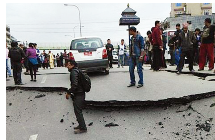
被地震破坏的道路
