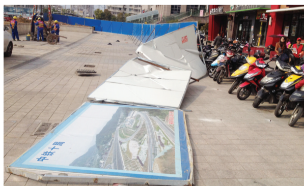
望江路潜山路交口一排施工围挡被吹翻
