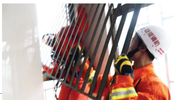
空调外机栅栏几乎被大风吹下 消防赶到排险
