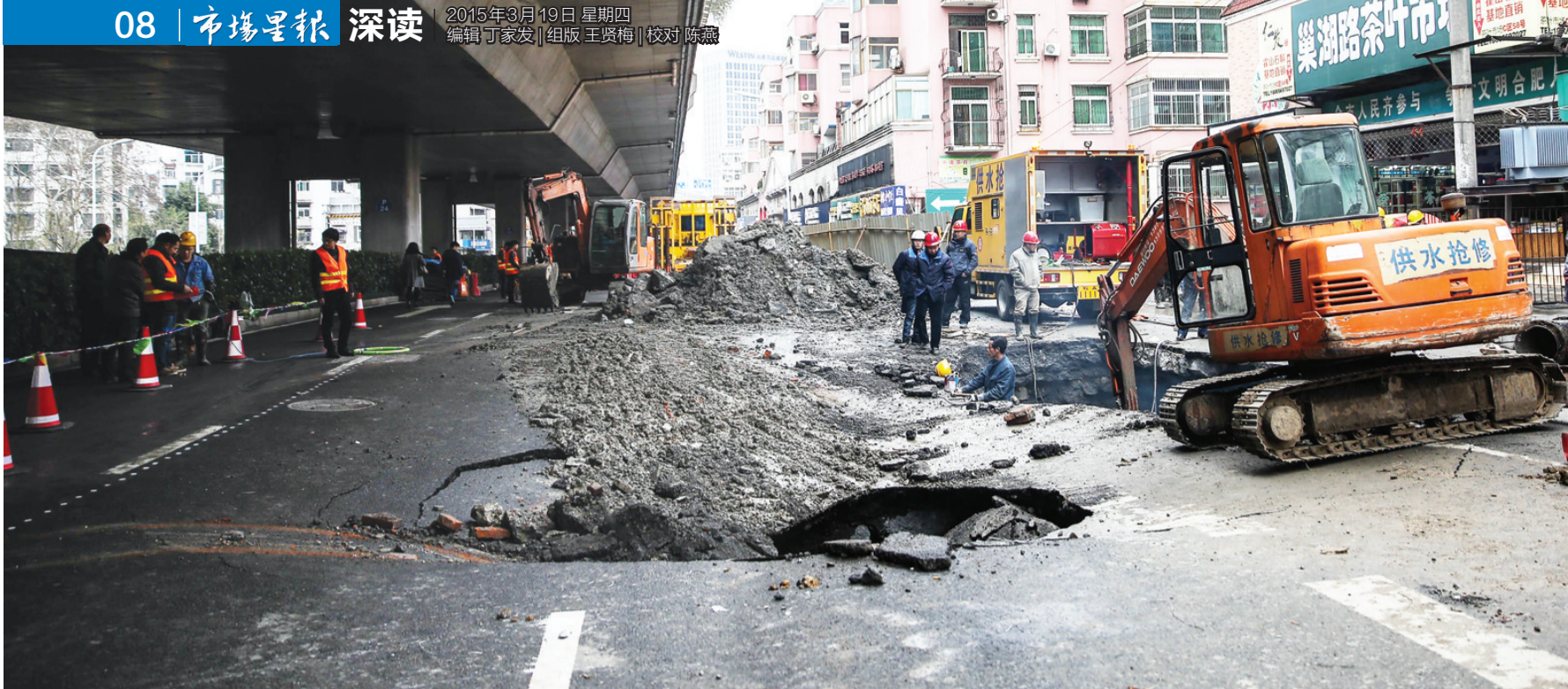
路面塌陷现场
