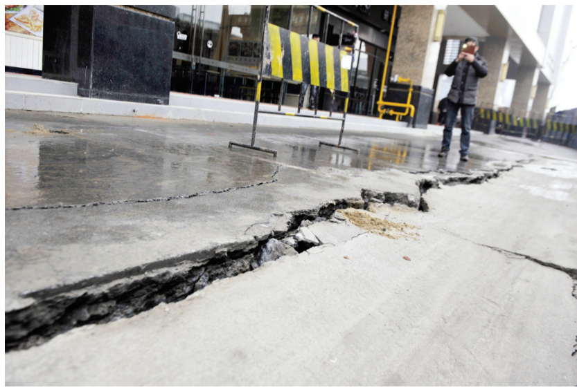
出现裂缝现场
