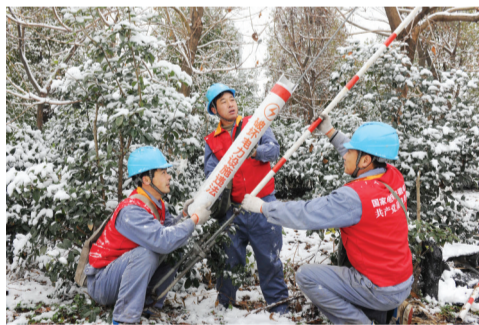
1月28日,滁州市供电公司的电力工人在抢修供电设备。 记者 胡昊/图
