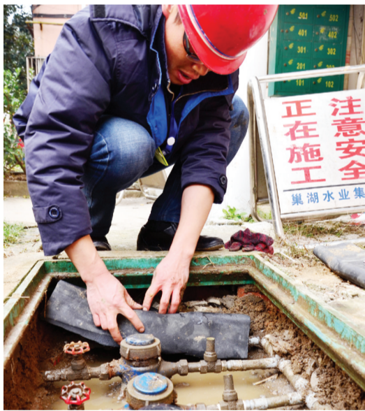
寒冬降临,面对气温骤降给供水设施带来的影响,巢湖市供水部门以“贴心小棉袄”进社区便民服务活动为契机,对居民水表、户外管道的保暖情况进行检查与维护,向市民宣传冬季用水防冻宣传。图为工人给水表穿“冬衣”。 蔡彬 记者 张发平 文/图
