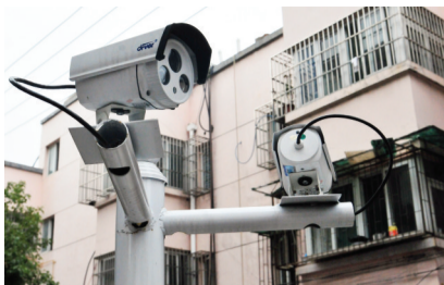
和平小区新安装的监控探头
