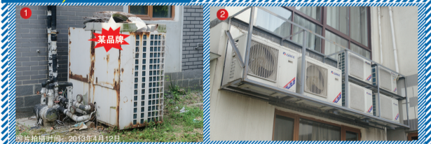
上面两幅图为省城合肥长江西路某知名别墅区空调外机实拍。图一为别墅交付时赠送配备的中央空调,由于质量问题,目前已经锈迹斑斑,根本无法使用,形成巨大的社会资源浪费。图二为另一业主拆除原来的中央空调外机,换了一排格力家用空调。好空调才能让您的财富更保值。
