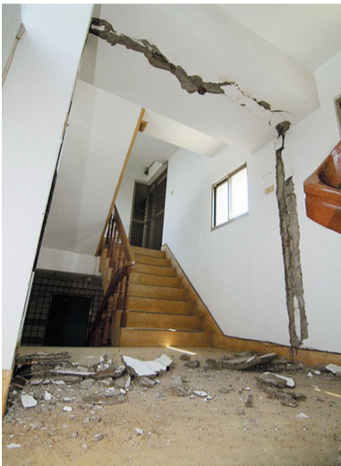
天花板和墙面都被震裂
