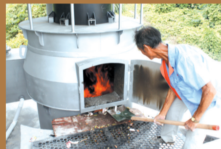
柏溪乡垃圾焚烧炉试运行
