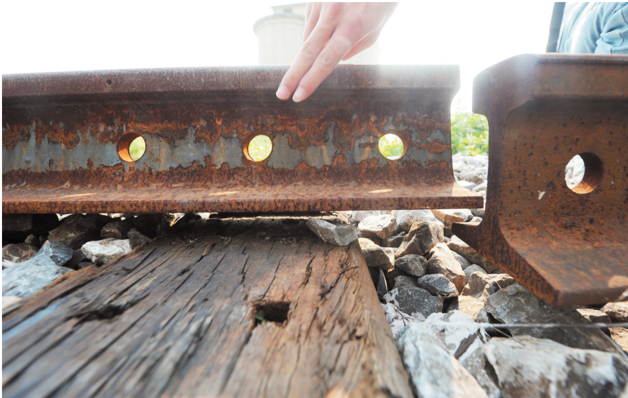
铁轨接板、螺丝、道木钉均被小偷卸掉
