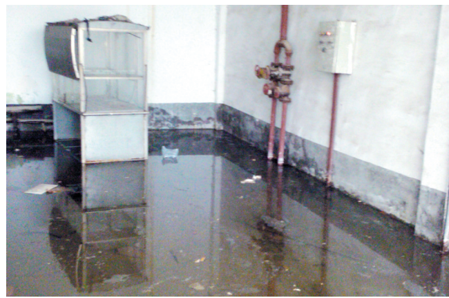
地下车库常年积水,墙壁都被泡坏了
