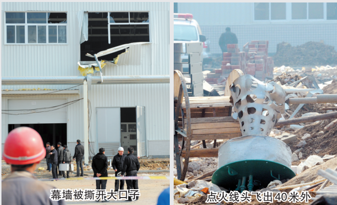
机器损毁严重
