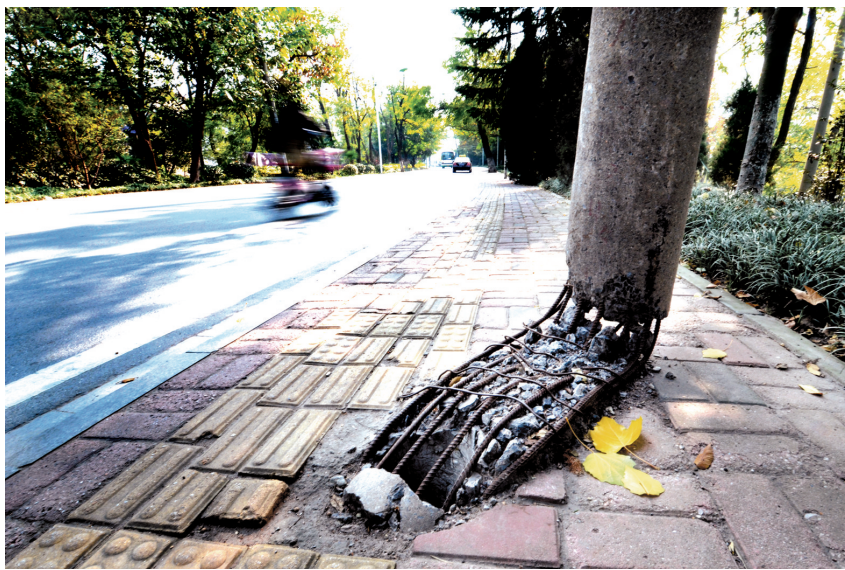
近日,合肥市环城北路路旁的一处电线杆根部钢筋裸露,过往行人远远避之。据现场观察,虽然电线杆上已无走线,可还是给汽车、行人留下安全隐患。
