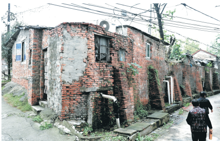
用墙垛支撑的危房
