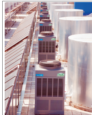
美的中央空调为8月12日在深圳开幕的第26届大运会运动员村提供公寓热水系统
