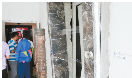
18层楼电梯门也变了形
