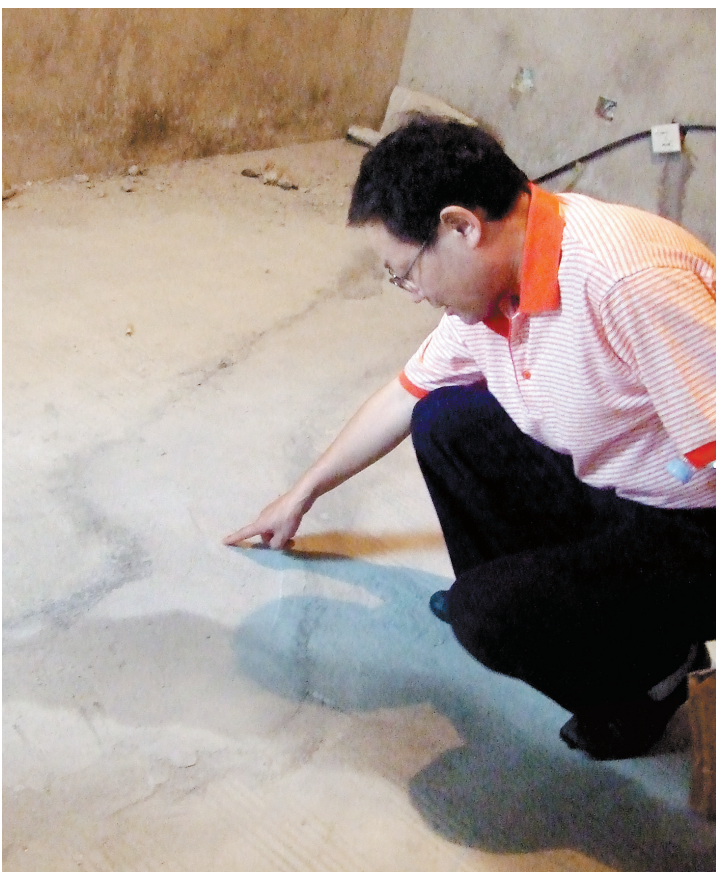
未经检测，承建商将裂缝堵上了
