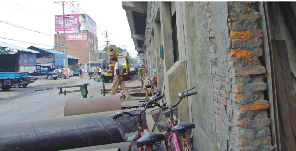
立交桥下数十间违建“危墙”仍未拆除
