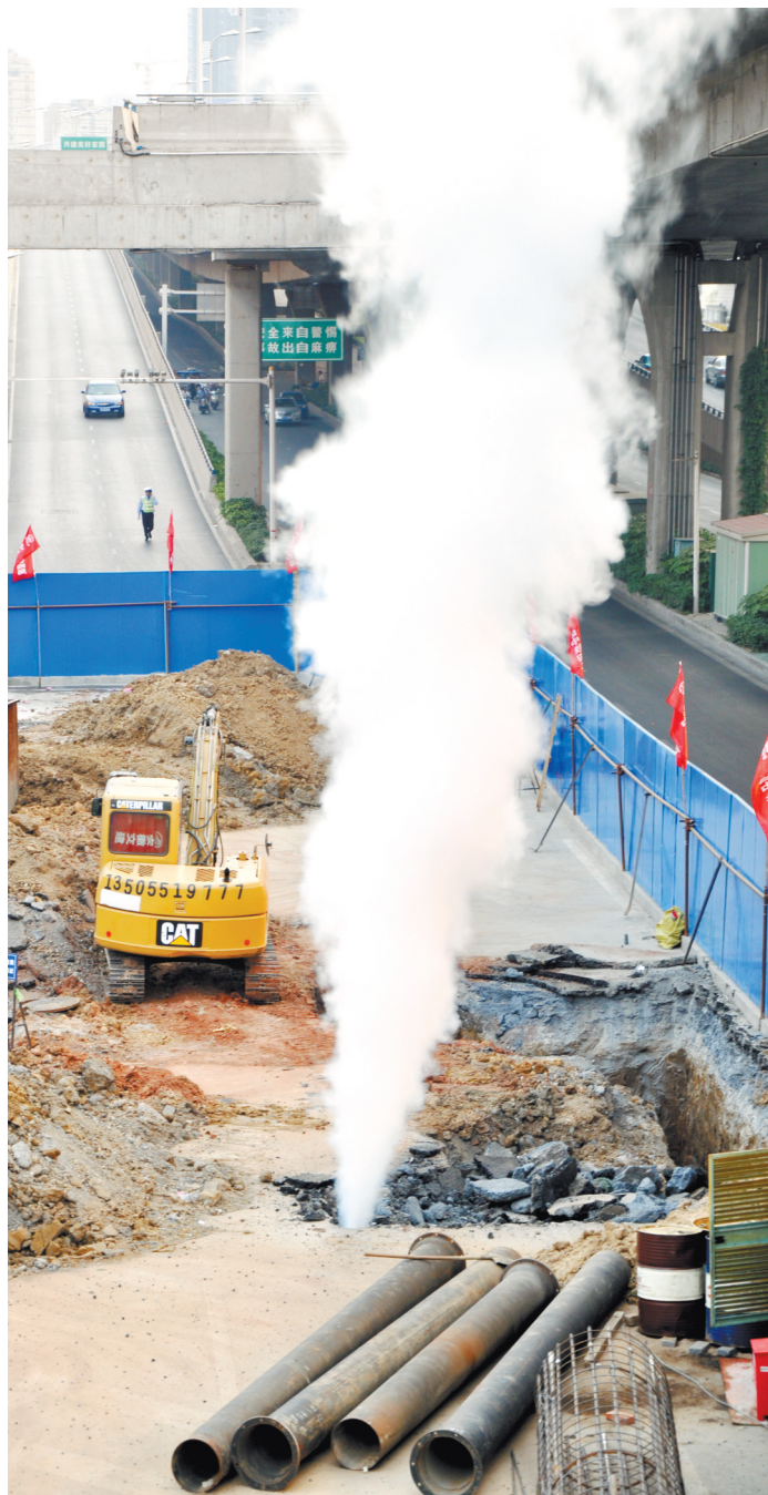
管道“破相”,气冲霄汉
