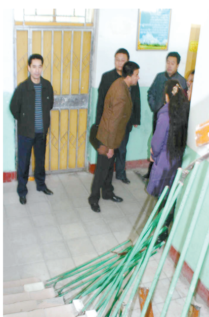
楼道的护栏已经变形
