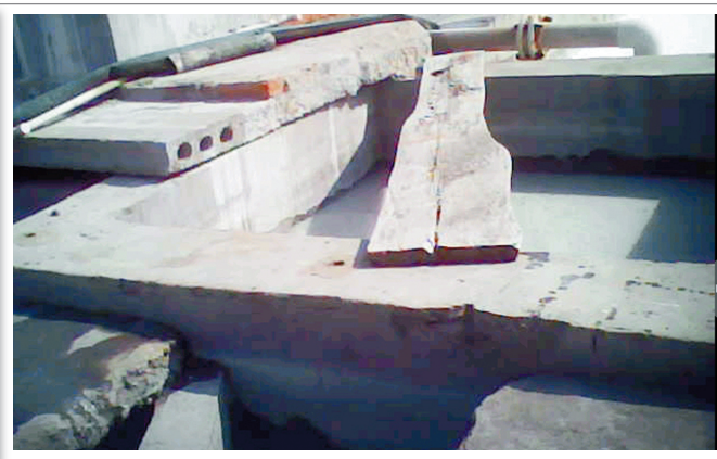
污水处理设备处于关闭状态
