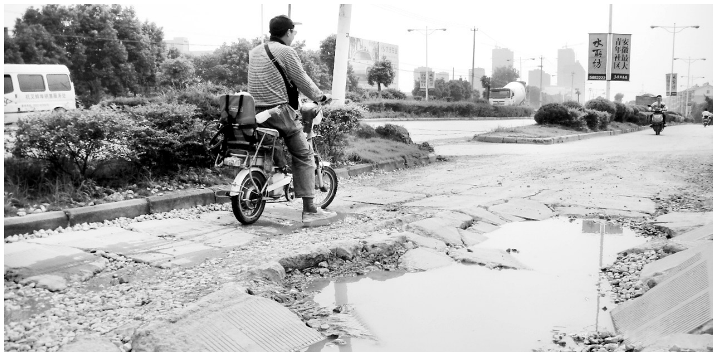
路面出现数米长的塌陷深坑
